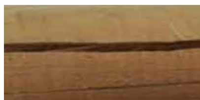
Fentes, gerces et fissures
